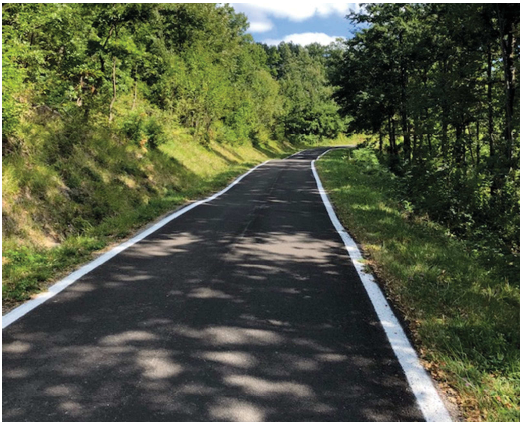
Foto 5: Cedimento sede stradale
