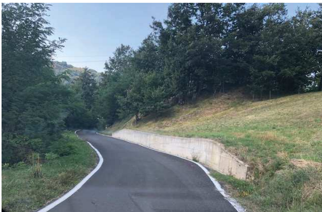
Foto 4: Cedimento sede stradale
